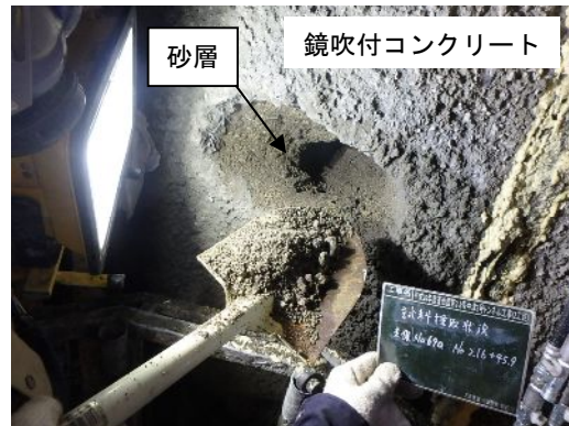
写真-2 脆弱な砂層
