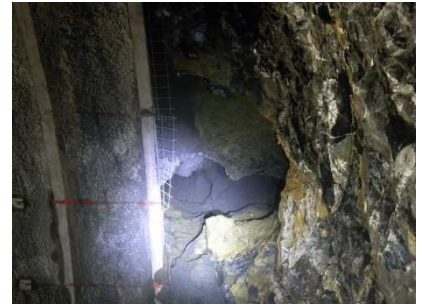
写真-1 空洞状況
