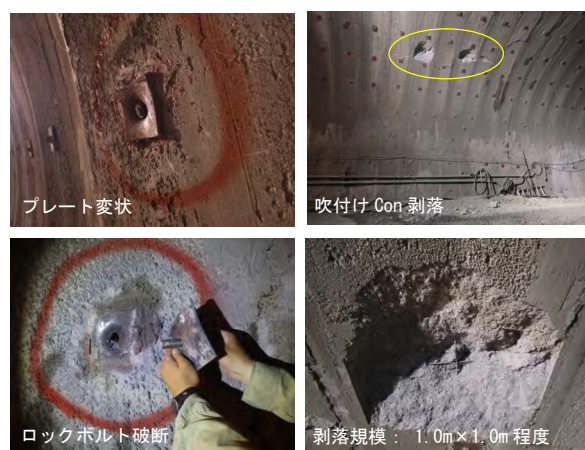
写真－3 支保工の変状状況
