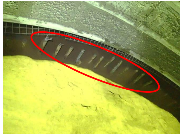
写真-1 鋼管下部の小崩落状況
