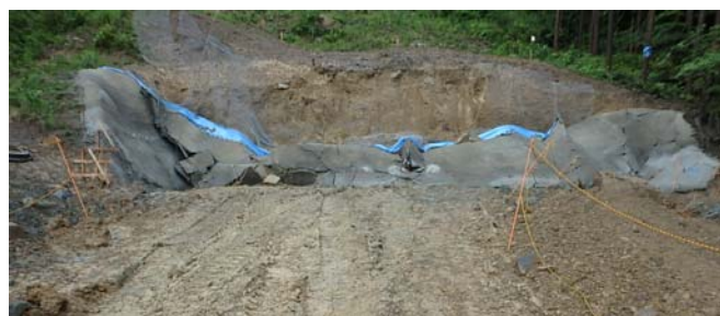
写真-1 坑口崩壊状況
