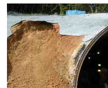
写真-1 のり面表層崩壊状況
