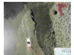
写真-2 坑内クラック発生状況
