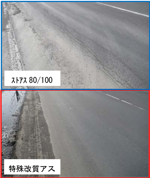
写真-1 ひび割れ状況
