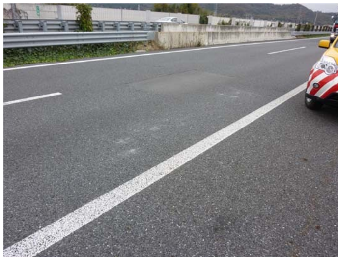
写真-1 ポンピング発生状況
