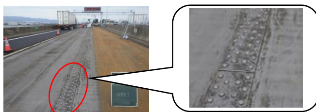
写真-3 研掃後の既設速乾プライマー残存状況
