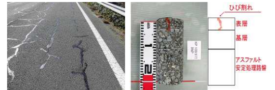
写真-1 KP109.975 の路面状況と採取コア
