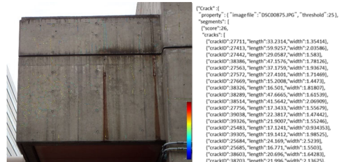
図-4 ひび割れ幅および長さ算出の例
