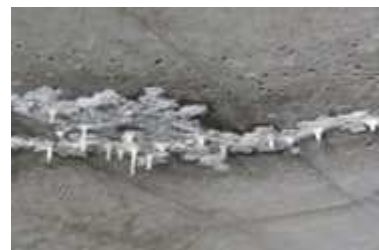
写真-1 つららの発生状況
