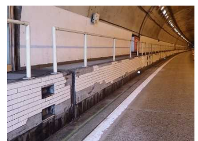
写真-2 中期型の劣化状況
