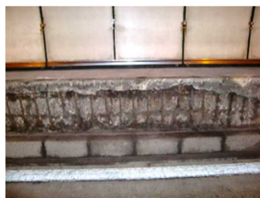
写真-1 初期型の劣化状況
