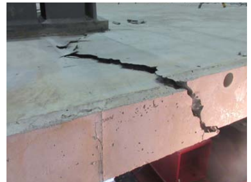
写真-2 破壊状況
