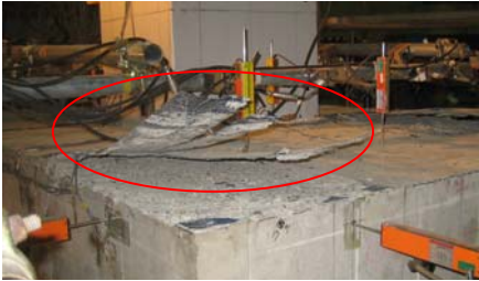
写真 3.1 炭素繊維シートの剥離(CA2)
