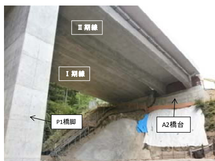
写真 1 未剛結状況(全体)
