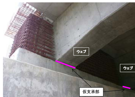
写真 2 未剛結状況(横桁)
