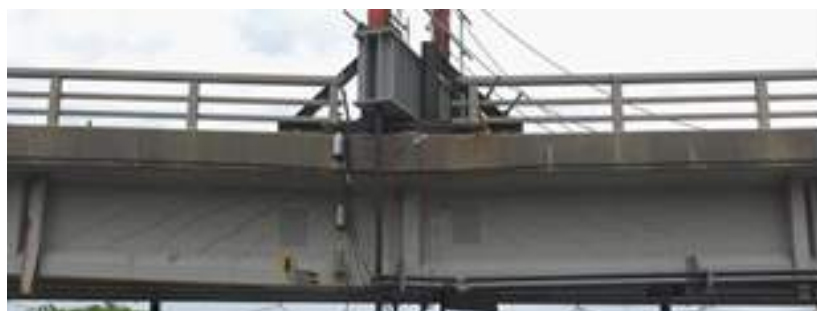
写真-2 載荷点付近の破壊性状
