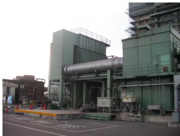
図1 空気圧縮機全景
