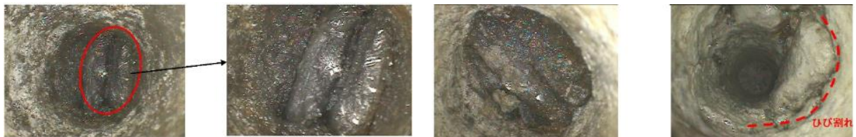
G2-G3 間 (PC 鋼材④) : 充填不足, 漏水) G2-G3 間 (PC 鋼材⑦) : 充填不足, 漏水)
