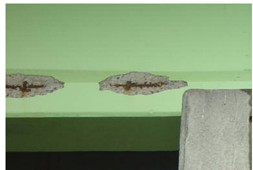
写真1 表面被覆後再劣化したPC構造物の例
