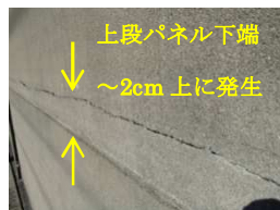
写真-3 ひび割れ状況
