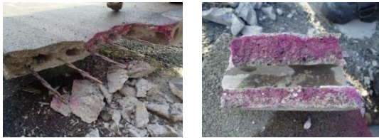
写真-4 変状パネル断面呈色状況
