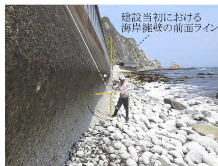
図 1 海岸擁壁の浸食状況
