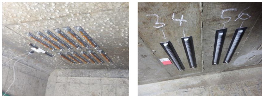
図3. 岐阜県内に設置されたMHにおける冬季の上床版の結露状況(撮影日 2017.2.14)
