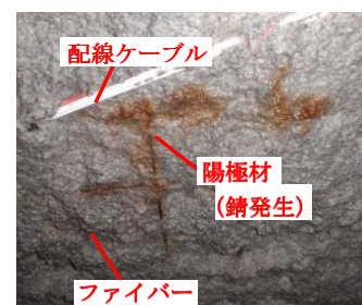
写真-3 陽極材の錆発生状況 (効率施工型でのみ発生)
