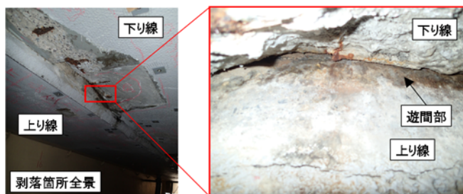
図-9 上下線の隙間 (遊間部) 状況
