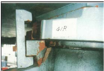
写真-2 BP支承サイドブロックの損傷
