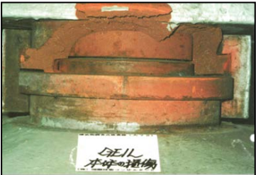
写真-1 BP支承上沓の破断
