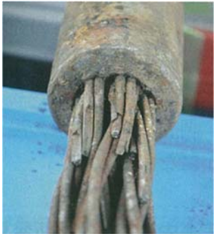
写真-1 PC 鋼線の破断 1)
