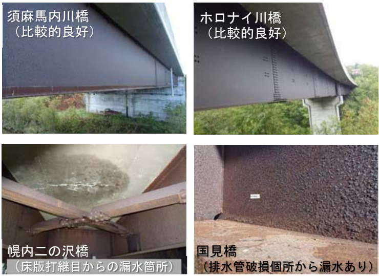
写真-1 耐候性鋼材発生状況
