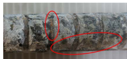
写真-2 鉄筋の腐食状況
