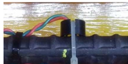
写真-1 センサとその設置状況
