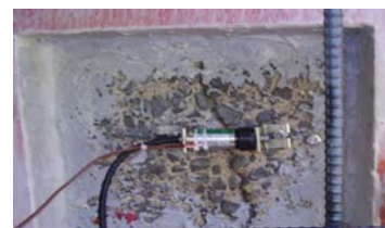
写真-1 亀裂変位計
