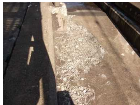
図-2 スラブ上面のスケーリング
