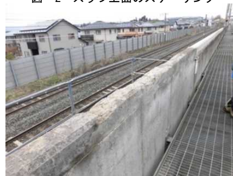
図-3 防音壁天端のスケーリング
