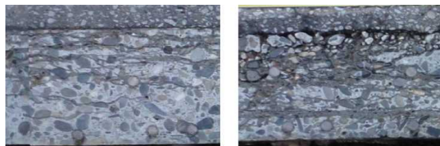
写真-1 疲労と凍害の複合劣化を受けた床版の断面 1)
