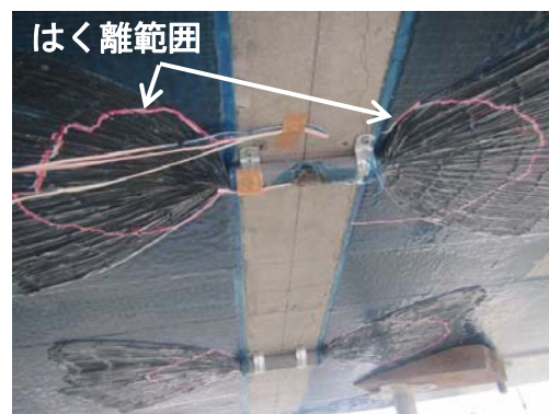
図-8 CF アンカーはく離状況
