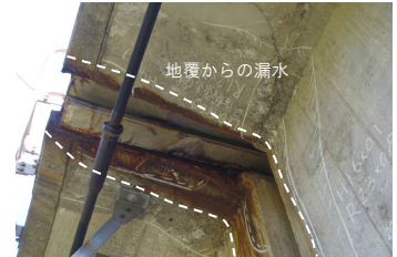
写真-1 劣化した張出床版下面
