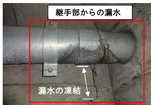
（写真-1 凍結による継手部からの漏水状況）
