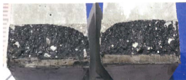
図-5 注入剤 B-① (初期ひび割れ 0.2 mm)
