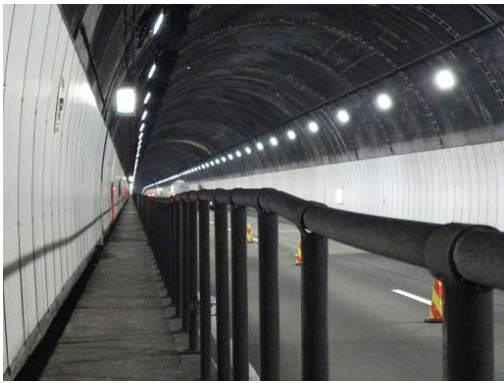
図-3 監視員通路手摺りの変形状況
