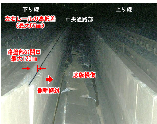
図-1 路盤部の被害状況
