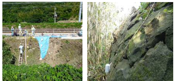
(a) 積み石の崩壊 (b) 積み石のはらみ出し
