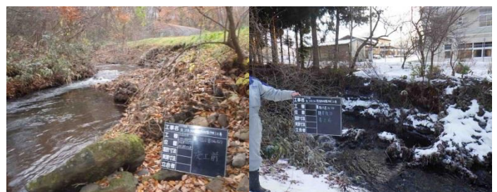
写真-2 河川法面の被災箇所
