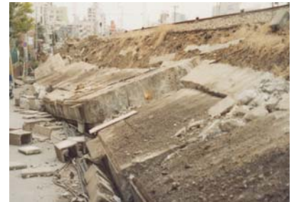
図-1 もたれ壁の被災の様子
