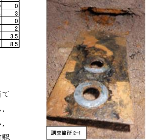
図-4 補強材の状態と鋼材厚さ (NO. 1-2)
