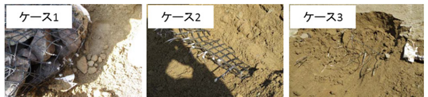
図-6 引抜き試験後の部材の破断状況
