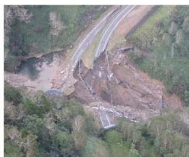
写真 3 盛土崩壊・土石流箇所
