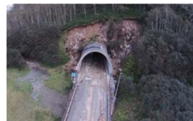
写真 1 斜面崩壊箇所
