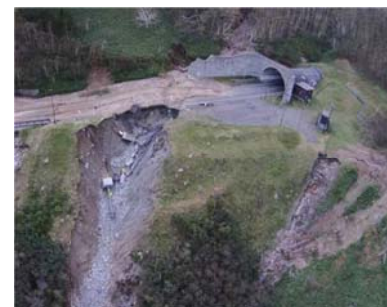
写真 4 盛土崩壊・土石流箇所
