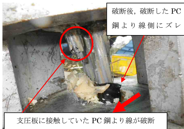
写真 3. 頭部背面のアンカー破断状況
