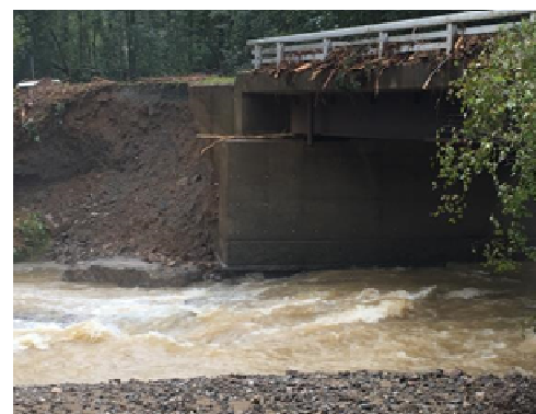
図-1 橋台背面盛土の被災状況例
