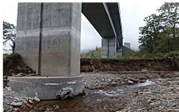
写真-1 洗掘を受けた構造物基礎
