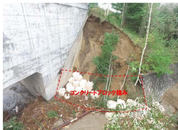
写真-2 洗掘箇所拡大
