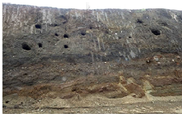
写真-1 確認された空洞
