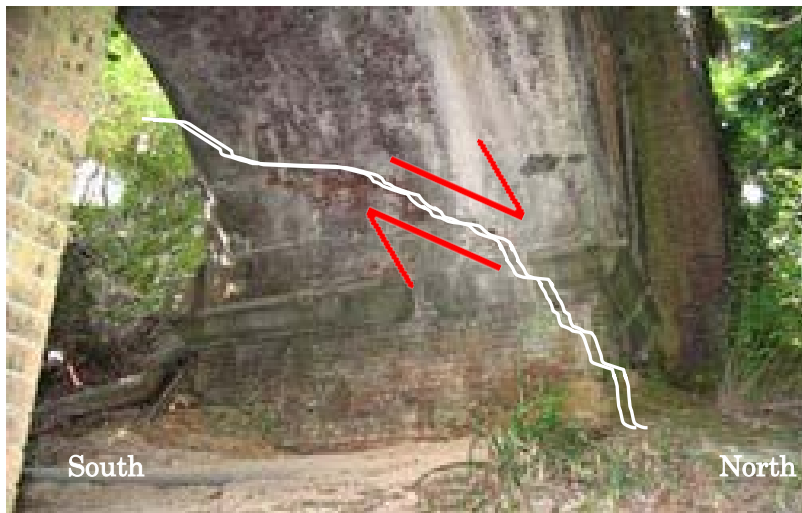
図 5 橋台に見られる亀裂の状態
