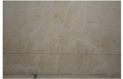
写真-1 頂版の不規則なひびわれの例
