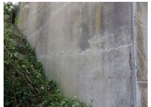
写真-3 乾燥収縮による ウイングのひびわれの例
