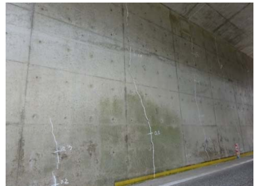
写真-2 側壁の鉛直方向ひびわれの例
